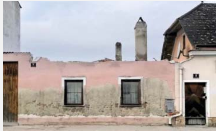
Abb. 23 (r.): In Horn wurde eine der ältesten Arbeitersiedlungen Österreichs irreparabel beschädigt
