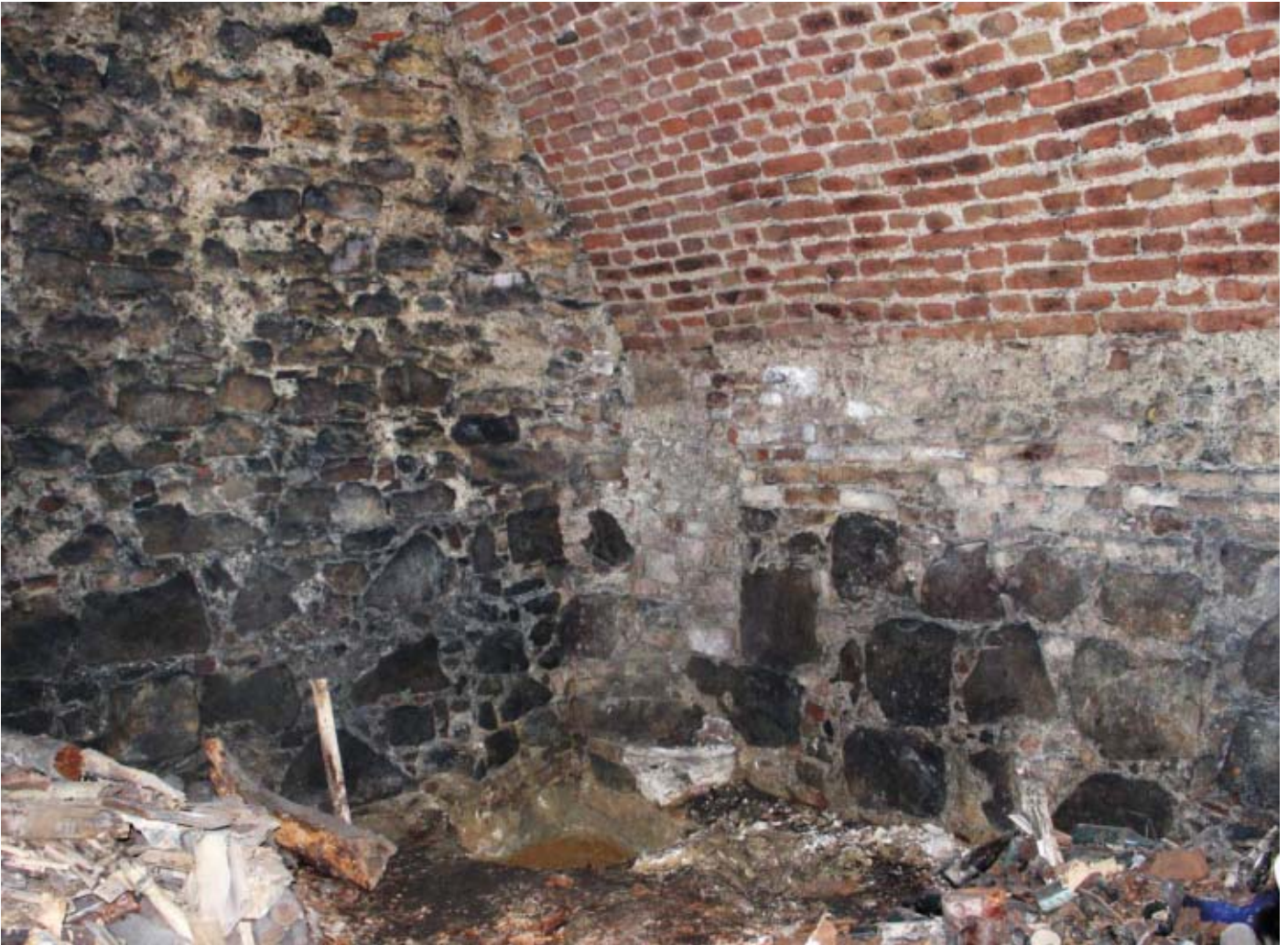
Abb. 16: Denkmalgeschützte bis ins Mittelalter zurückreichende Steinmauern aus verschiedenen Epochen, Ansicht im Jahr 2014, heute durch eine dicke Schicht Spritzbeton de facto zerstört
