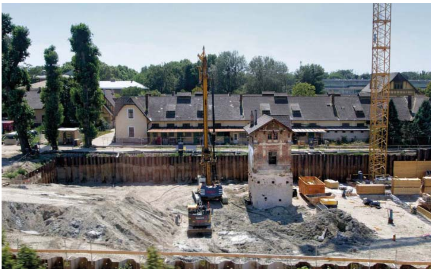
Abb. 8 (oben): Detailfoto des nordwestlichen Eckbaues von Stall VIII nach Zerstörung des Mittelteils, noch vor Beginn des Bodenaushubs für eine Großtiefgarage; Abb. 9 (unten): Blick von der U-Bahn auf den nordwestlichen Rest des denkmalgeschützten Stalls VIII (Bildmitte), rundherum wird der Boden für die Großtiefgarage des geplanten Hochhauses ausgehoben. Im Hintergrund Stall VI, in dem sich noch (im Foto nicht sichtbar) Pferde befinden. (Foto Juli 2019, © Thomas Keplinger)
