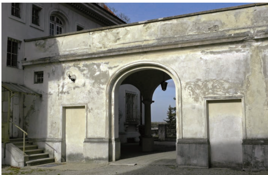
Abb. 86 (o.): Die Rostock-Villa in der Schießstattgasse 2; Abb 87 (u.): Sanierungsbedürftige Mauer im Hof der Rostockvilla
