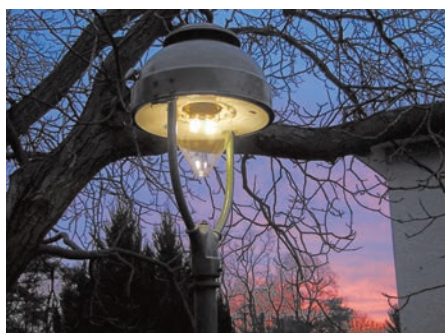
Abb. 73: Gasleuchte auf Stahlmast, Modell 52 der Fa. Schneider in Hamm, nur noch in Frankfurt/Main anzutreffende Leuchte zum Montieren auf bzw. seitlich an einem Mast.
