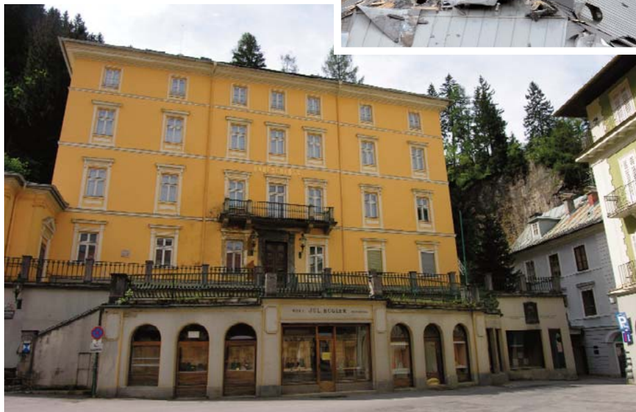
Abb. 94-95: Badeschloss in Badgastein/Salzburg, Schäden am Dach des Badeschlusses nach der Brandstiftung vom März 2013
