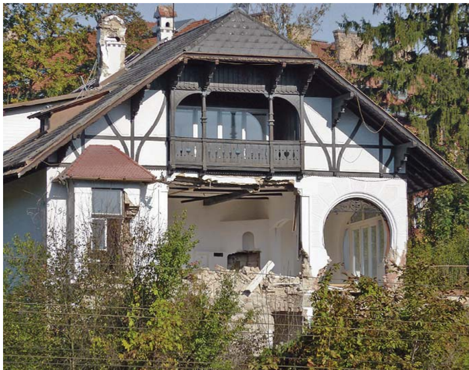
Abb. 92: Villa Seewald (Pressbaum, Krumpöckgasse 3, NÖ) im November 2013: Unsensible Teilabbrüche und geplante Umschließung mit Hochbauten.
