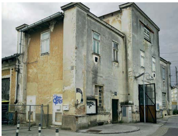
Abb. 35: Der renovierungsbedürftige Bürotrakt der 1914 erbauten Halle des Schwechater Eisenbahnmuseums
