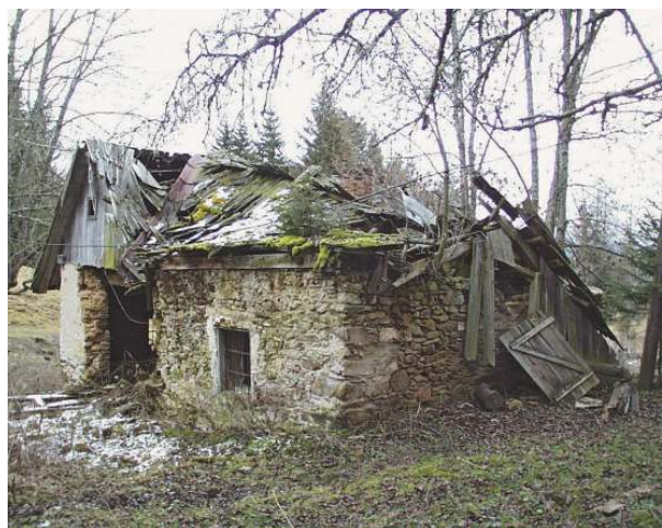
Abb. 20: Eines der verfallenden Nebengebäude von St. Jakob am Mitterberg
